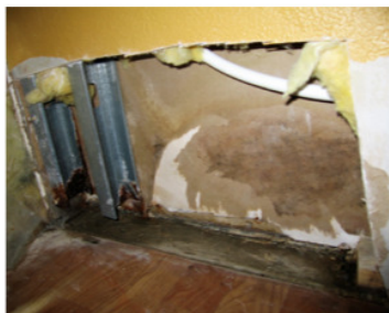
5. Uttøking av skadested
