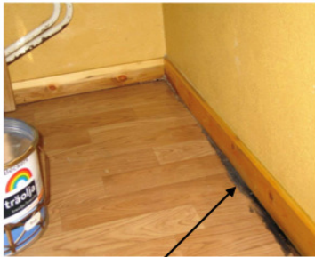
1. Indikasjon på bakenforliggende fuktskade i vegg fra bod mot dusjnise med muggsopp
