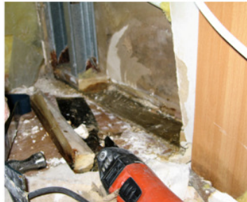
2. Åpning av skadested fra bod inn mot dusjnise. Tydlig fuktskade og muggsopp
