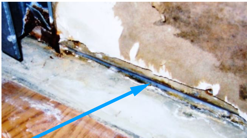
Vannfuge som oppstår mens en person dusjer inne i dusjnisen på motsatt side av vegg.
