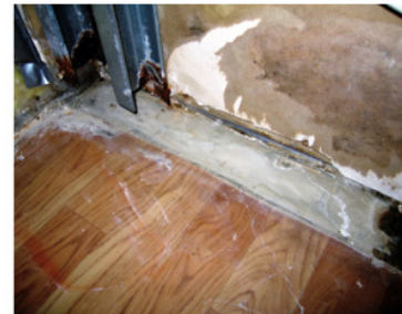
6. Uttøking av skadested
